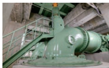
高橋雨水ポンプ場
