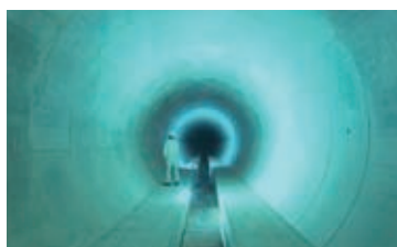
下川原雨水貯留管
